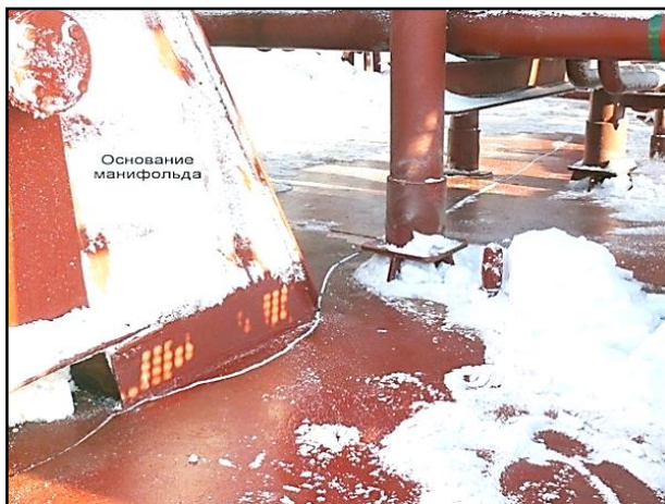
Хрупкое разрушение палубы танкера «Индига» при ледовой проводке при -24°C
