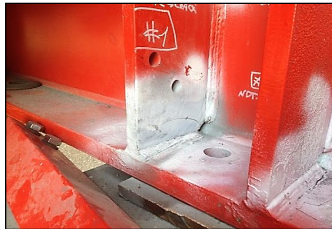
Хрупкое разрушение сварной конструкции из импортной стали S690QL после сварки на стапеле
