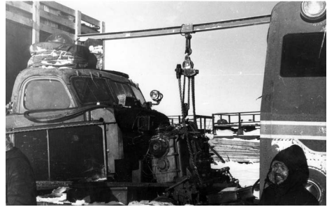
Ремонт коробки передач на АТТ 15 во время похода
